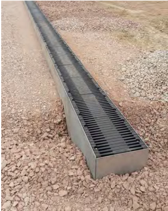
Lebensmittelmarkt in Rheinland-Pfalz. Niederschlagswasser der Verkehrsflächen / Parkplätze wird vor der Versickerung in einer Regenwasserbehandlungsanlage, bestehend aus einer speziellen Linienentwässerung, auf 288 m Länge gesammelt und gereinigt. Foto: Müller + Huber
