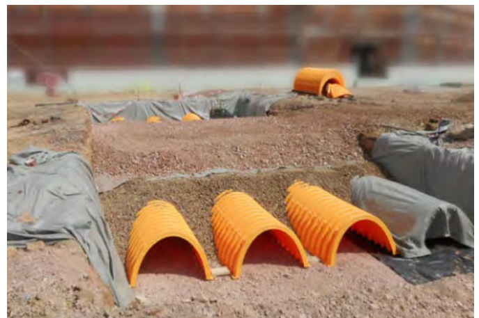
Lebensmittelmarkt in Rheinland-Pfalz. BIRCO Rigolentunnel von StormTech® bilden in einer oder mehreren Reihen eingebaut die zentralen Bauteile der drei Regenwasser-Versickerungsanlagen. Foto: Müller + Huber
