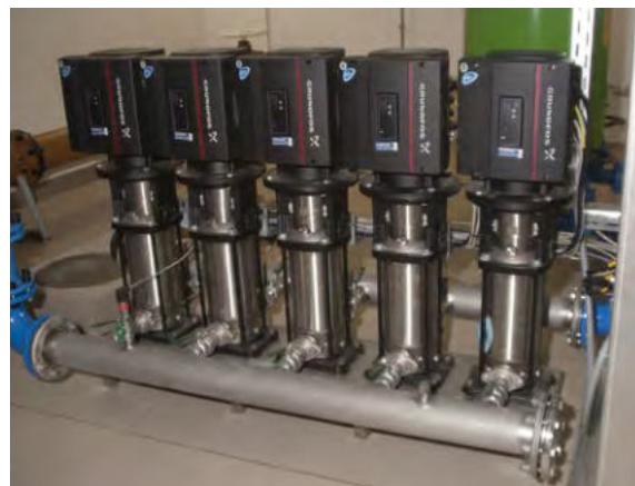
Nach dem Austausch der Pumpentechnik im GPW Wolkertsham. Die Aufgabe übernimmt eine Hydro MPC-E 5 CRIE 10-9. Steuereinheit CU 354: alle relevanten Daten stehen auf dem Display zur Verfügung.
