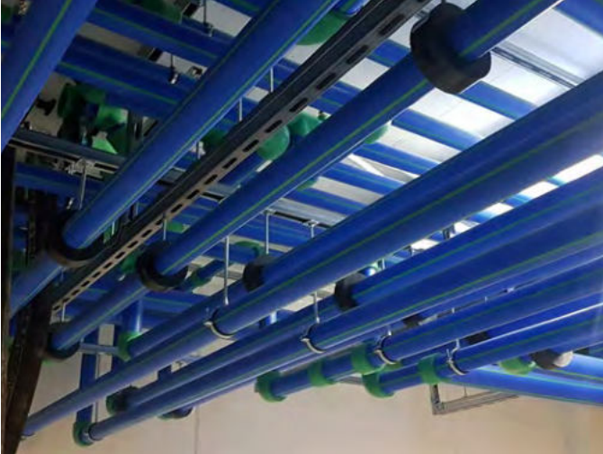
Für die gesamte Kälteverrohrung des CIO wurde aquatherm blue pipe eingesetzt. Foto: aquatherm GmbH
