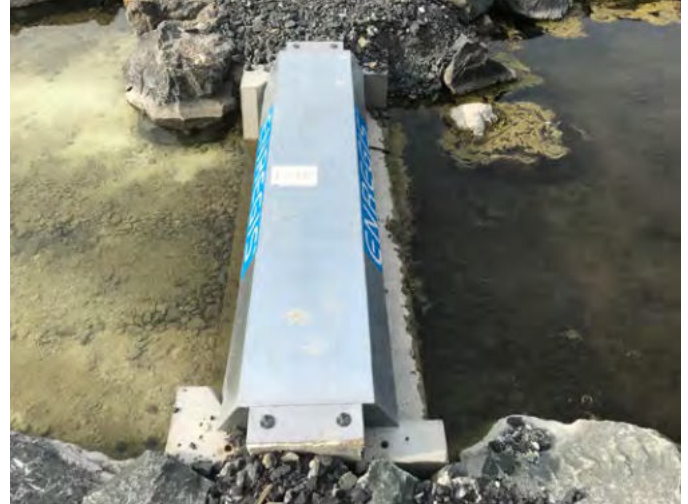
Links neben ENREGIS/Vivo® TRP der Absetz-/Filterbereich, rechts Rückstau des Pulverriedgrabens.
