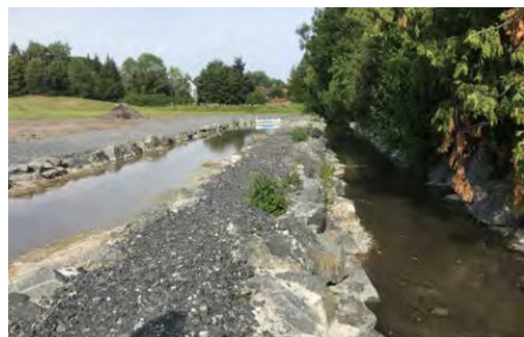
Rechts der Pulverriedgraben; links der Absetz-/Filter-Bereich mit ENREGIS/Vivo® TRP am Auslauf.
