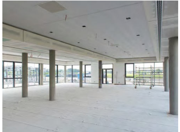
Kühldecken sorgen in der großzügig verglasten Kantine des Neubaus für angenehme Temperaturen zu allen Jahreszeiten.
