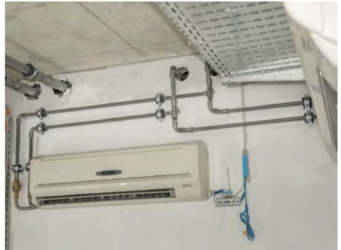
Auch für die Anbindung der Klimageräte kam das Viega-Rohrleitungssystem „Megapress“ zum Einsatz.
