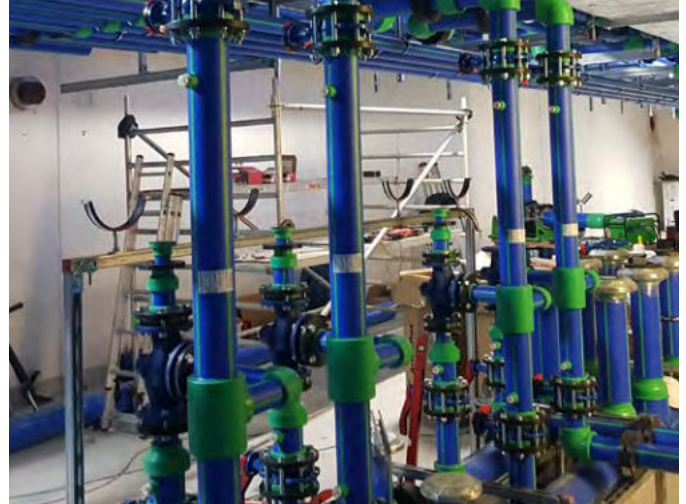
Die Verteiler wurden in der aquatherm Vorfertigung hergestellt und einbaufertig auf die Baustelle geliefert. Foto: aquatherm GmbH
