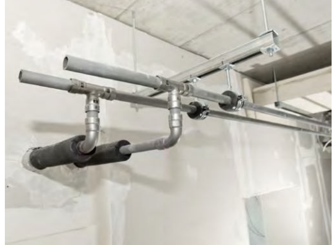
Rund 2,4 Kilometer Rohr und fast 2.500 „Megapress“-Verbindern von Viega wurden für die Wärme- und Kühleitungen installiert.
