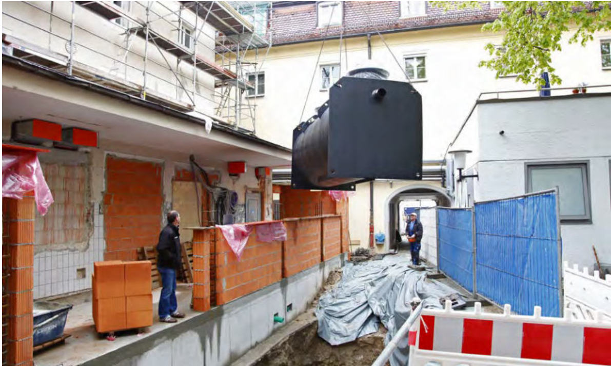
Bild 5: Die angelieferten Einzelteile gelangten per Kran in die offene Baugrube. Anschließend installierten die Monteure Abscheider und Hybrid-Hebeanlage. (Bild: KESSEL AG)
