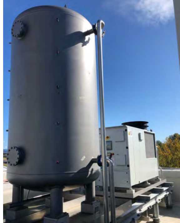
Bild 4: PCM-Latentspeicher 5 m 3 mit Flüssigkeitskühler (50 kW) als Lademaschine
