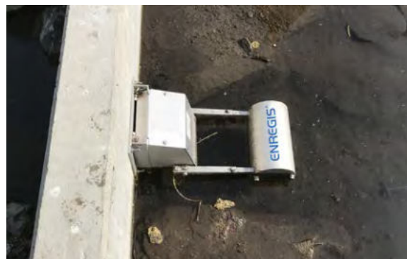
Das Schwimmersystem „ENREGIS/Limit Control Slide“ verschließt den Zulauf bei Regen, sodass der Niederschlag in die Absetz- und Filterweiche umgeleitet wird.
