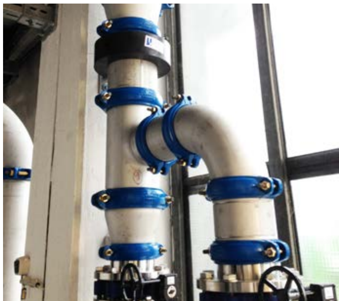
Brunnenwasser mit StrengThin™ 100 | Quelle: Victaulic
