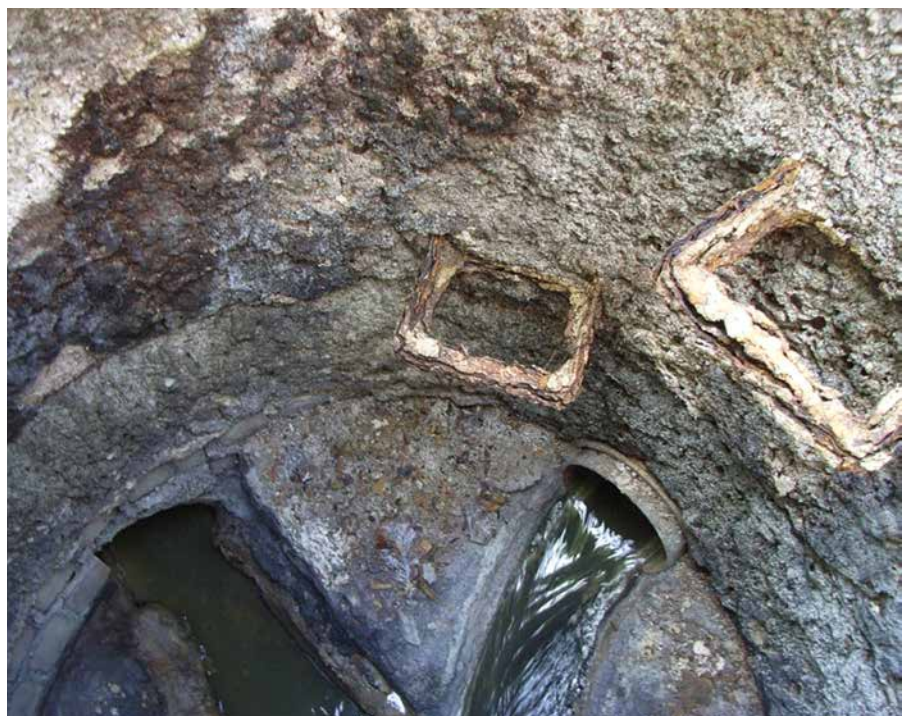
Biogene Schwefelsäurekorrosion | Quelle: © UNITECHNICS
