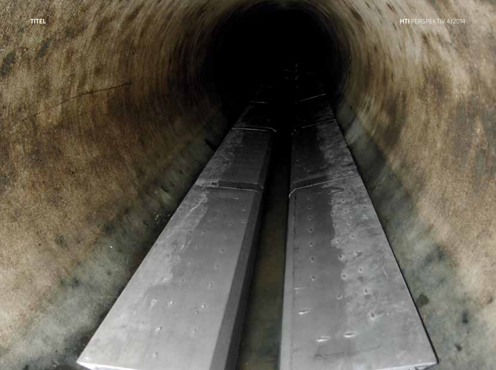
Ein Wärmetauscher im Abwasserkanal verändert den Röhrendurchmesser nur marginal. (Quelle: HUBER SE)
