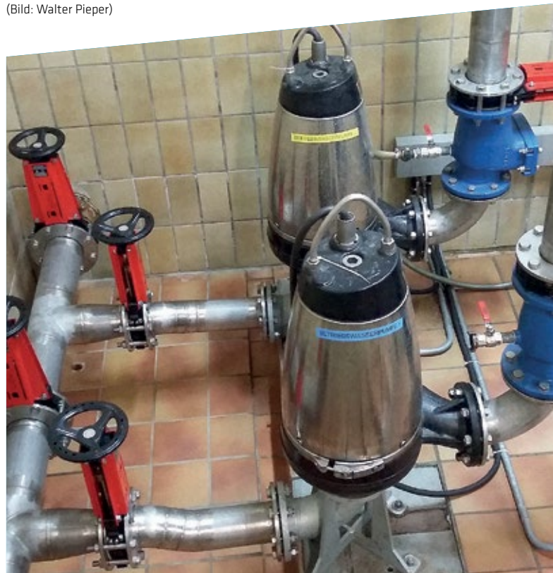
Pumpen Regenüberlaufbecken: vertikal trocken aufgestellt. (Bild: Walter Pieper)
